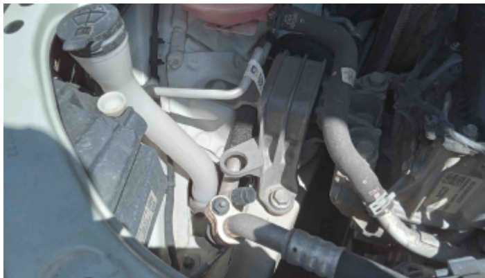
Foto Ar Condicionado
