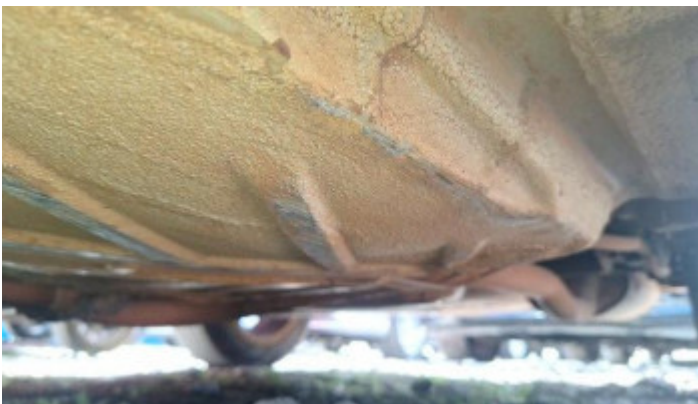
Foto Avaria Assoalho (Lado esquerdo)
