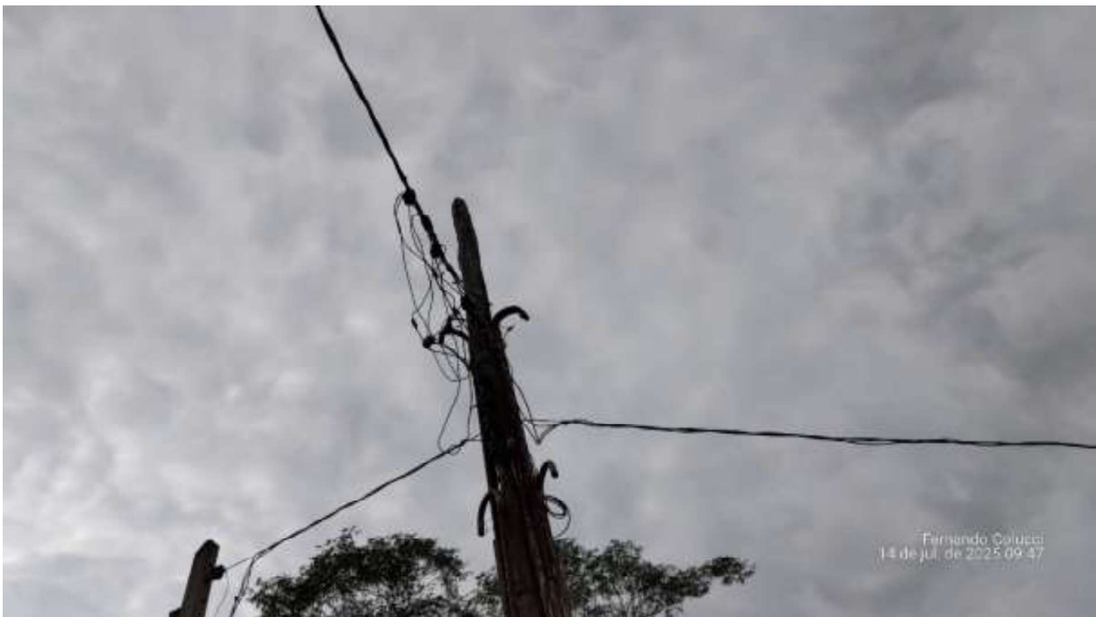
Figura 5 - Vista do poste que dá acesso a eletricidade ao imóvel
