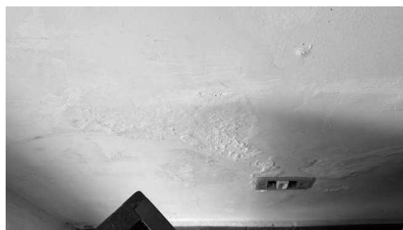
Pontos de umidade (ed. Averbada)
